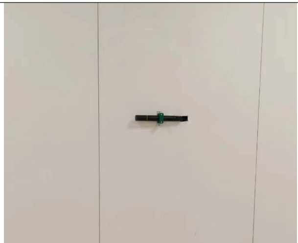
图4 机房内报警仪探头
