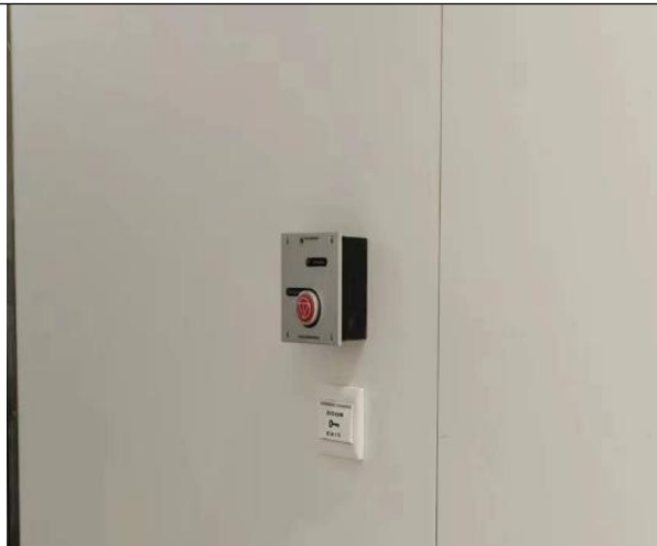
图5 机房内应急开关
